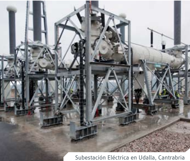
Subestación Eléctrica en Udalla, Cantabria
