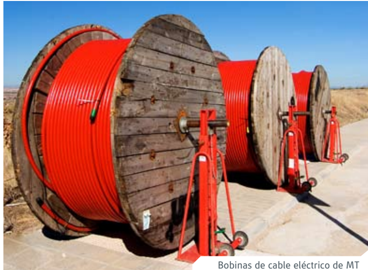
Bobinas de cable eléctrico de MT
