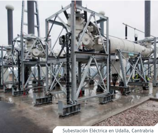
Subestación Eléctrica en Udalla, Cantabria
